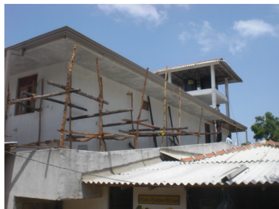
Die Dach-/Deckenverkleidung am Balkon und innen im ersten Stock wird im Moment gemacht!
